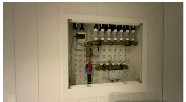
Rørskap og stoppekran.
