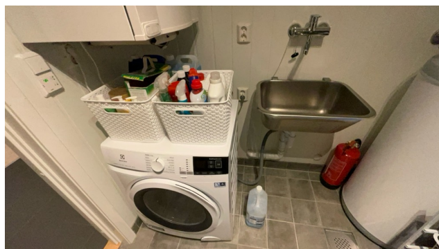
Skyllekar og opplegg for vaskemaskin
