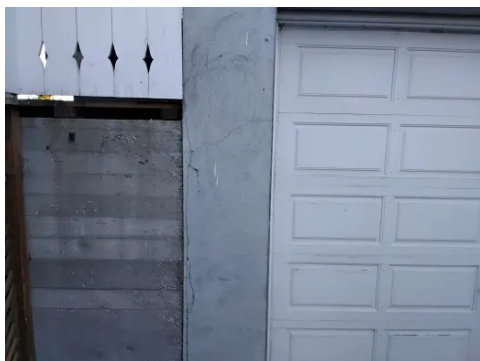
Eksempel på sprekker/riss i grunnmur.
