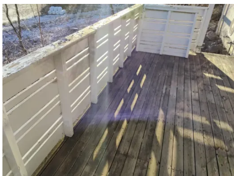
Manglende vedlikehold og skjevheter i terrasse.
