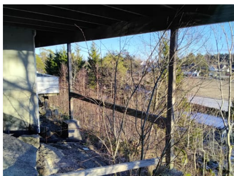
Underdimensjonerte bæringer/søyler under deler av terrasse.
