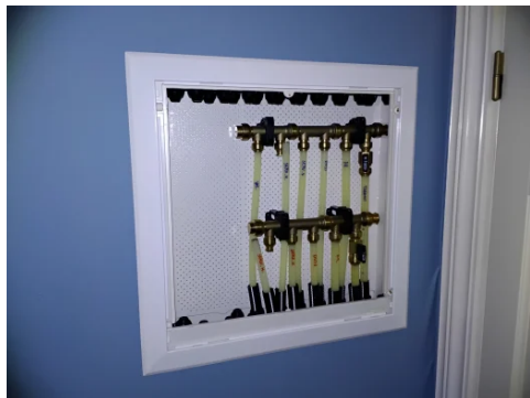
Vannskap i 2. etg.
