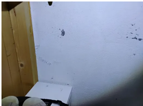
Eksempel på saltutslag ved bod i underetasje.
