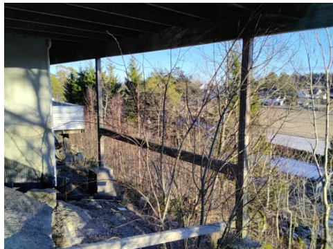
Underdimensjonerte bæringer/søyler under deler av terrasse.
