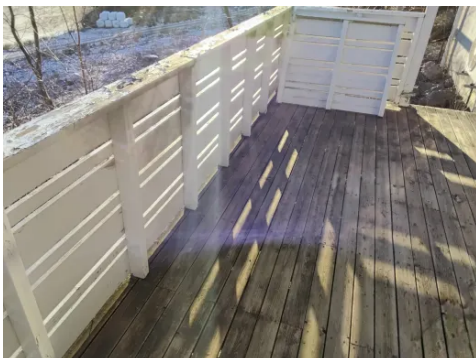
Manglende vedlikehold og skjevheter i terrasse.
