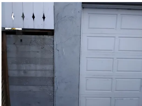
Eksempel på sprekker/riss i grunnmur.
