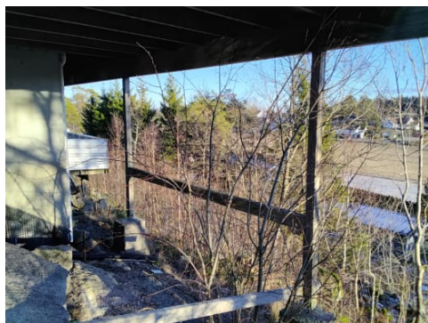
Underdimensjonerte bæringer/søyler under deler av terrasse.
