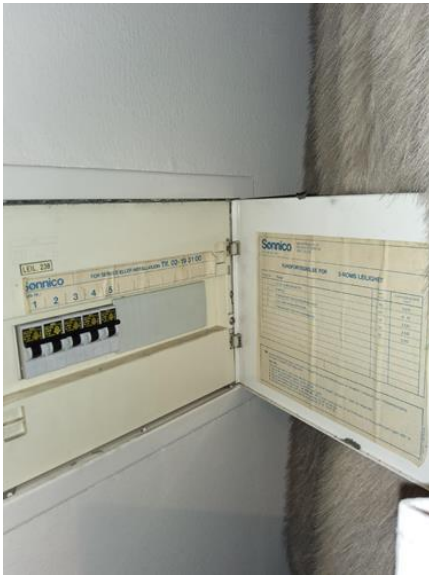
Elektrisk anlegg - [Sikringskap ]
