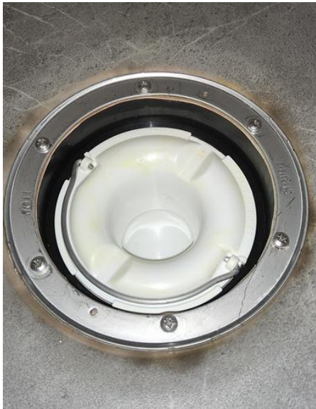
Avløpsrør (ink. sluk) - [Sluk bad]
