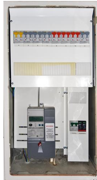
Forenklet vurdering av det elektriske anlegget - [Sikringsskap]
