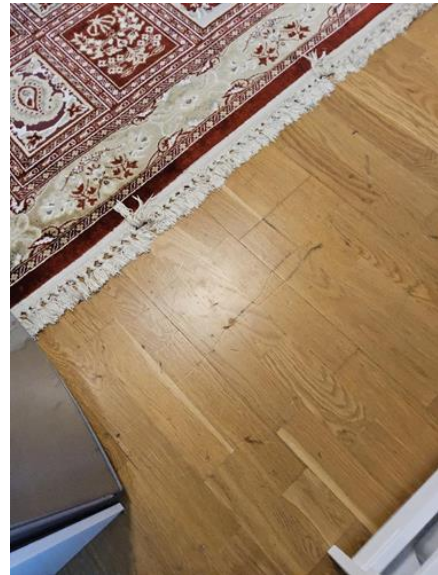
Kjøkken - [Riper/merker på gulvoverflater.]
