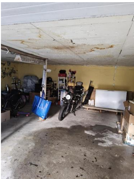
Frittstående byggverk - [Lekkasje i garasje. ]
