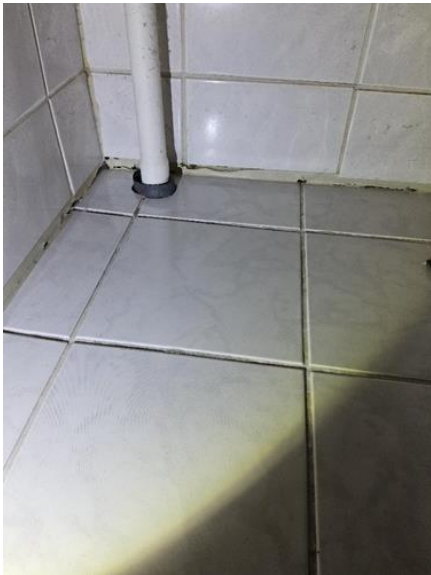
Våtrom - [Manglende vedheft/store fugeglipper. ]
