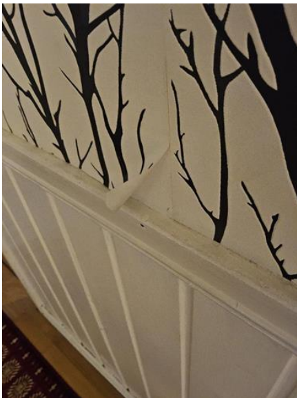
Øvrige rom [eksklusive spesialrom] - [Slitasje på veggoverflate.]
