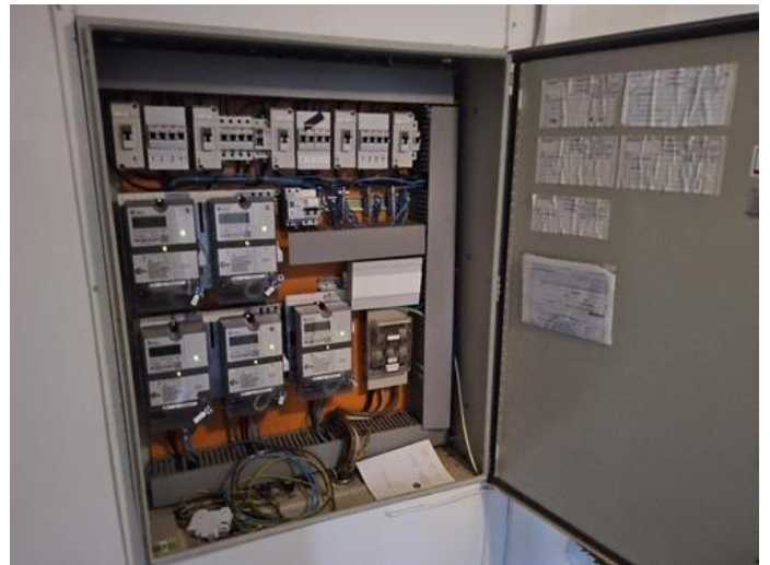
Elektrisk anlegg - [Sikringsskap. ]
