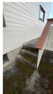
Trapp til veranda. Mangler håndløper på vegg
