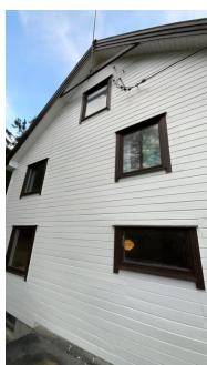
Oversikt. Sprekk i bod/lager vindu
