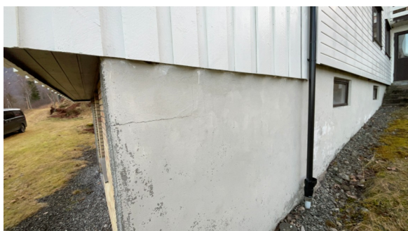
Riss/sprekke i puss
