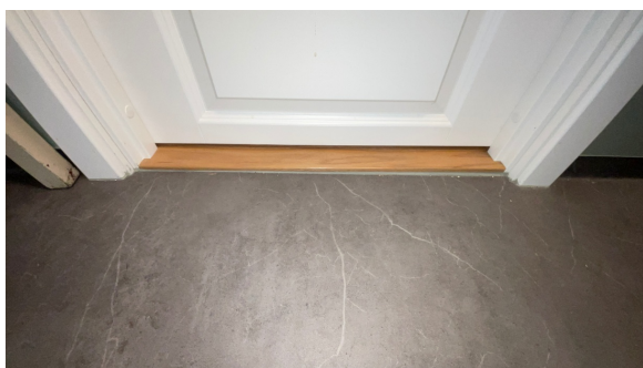
Tilluftsspalte under dør
