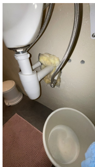
Åpning for rør og synlig isolasjon under servant må tettes
