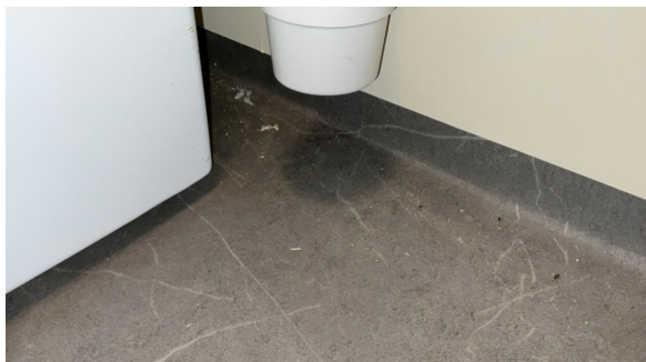
Mangler mykfuge/sokkellist i bunn av veggplater. Bør monteres mykfuge
