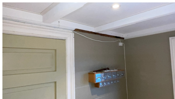
Løs kabel på kjøkken som må festes og kontrolleres av fagkyndig personale
