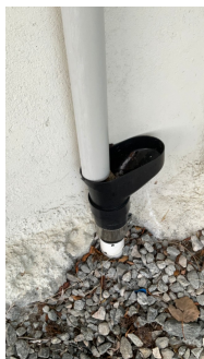
Montert rensetrakt for løv/avfall på taknedløp
