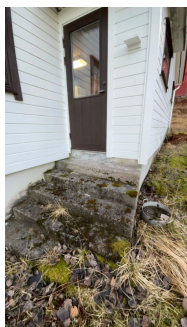
Trapp ved inngang til lager/bod. Mangler håndløper på begge sider
