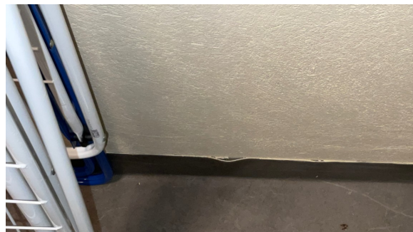
Mangler klemlist/mykfuge i overgang mur og beleg. Det bør monteres
