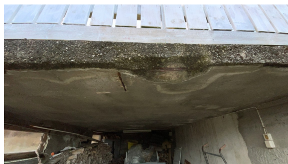
Skade i betongdekke
