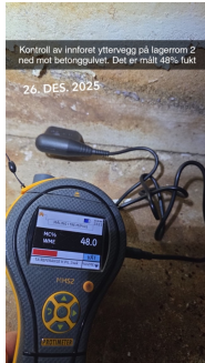
Fuktmåling er utført på vegg inne på lagerrom 2. Fuktmåling viser 48%
