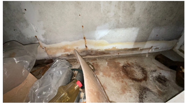
Bildet viser fuktskader i bakre bod i underetasjen
