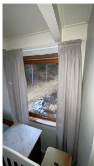
På soverom 3 i 2. etasje mangler det lister rundt vinduet
