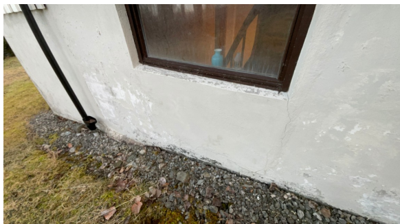
Sprekk i mur og puss under vindu av eldre dato
