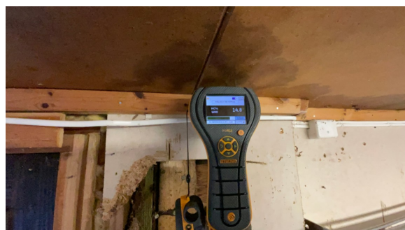
Kontroll av eldre fuktskade i himling på lagerrom. Det er målt 14,8%. Ingen forhøyde fuktavvik ved befaringen. Risiko for skjulte skader
