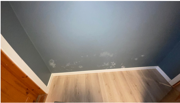
Saltutslag på vegg i vindfang
