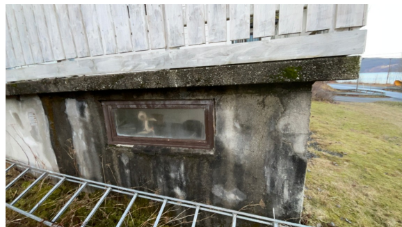
Mangler puss rundt vindu og det er synlig fukt ned langs veggen
