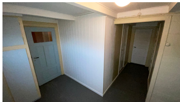
Vegg i gang 2. etasje er ikke ferdig pusset og malt
