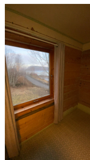
På soverom 1 i 2. etasje er det synlig isolasjon under vinduet og det mangler lister rundt vinduene. Deler av tømmervegg er pusset.
