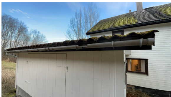
Skade i takrenne
