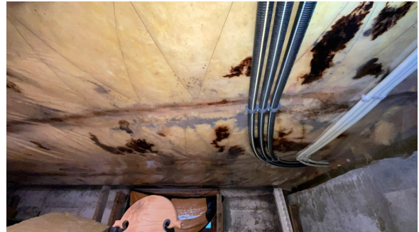
Mørke flekker over dampsperre i himling etter avføring fra mus i kombinasjon med eldre fukt. Normalt skal det ikke være dampsperre i etasjeskiller. Anbefaler å fjerne den og undersøke konstruksjonen nærmere
