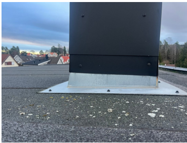
Beslag på utvendig pipe.
