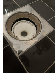
Sluket på baderommet i første etasje.
