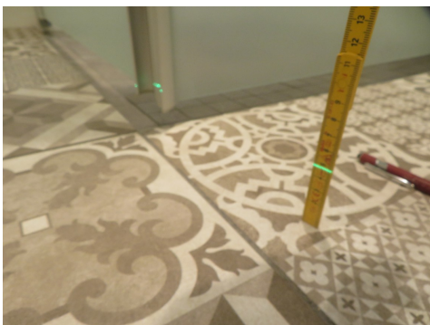
Bildet viser motfall ved toalett.
