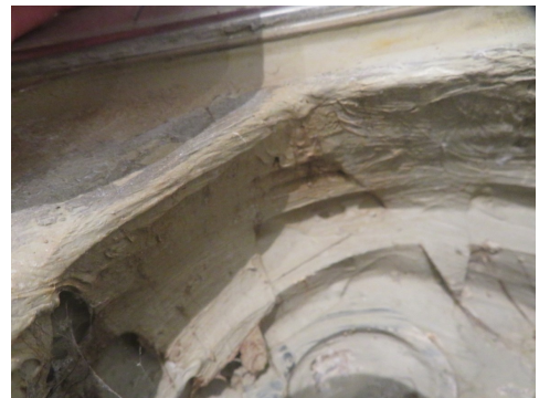
Ikke fagmessig membranløsning i sluk.
