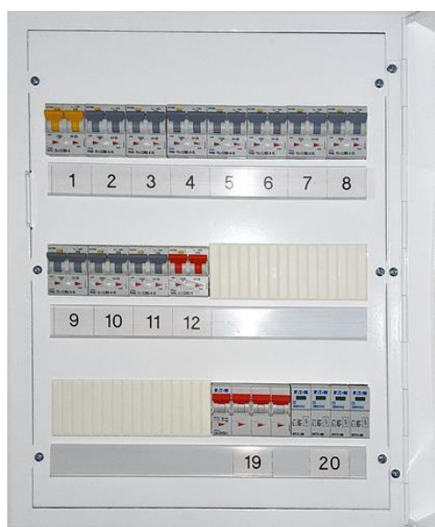
Forenklet vurdering av det elektriske anlegget - [Sikringskap]
