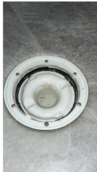
Avløpsrør (ink. sluk) - [Sluk vaskerom]
