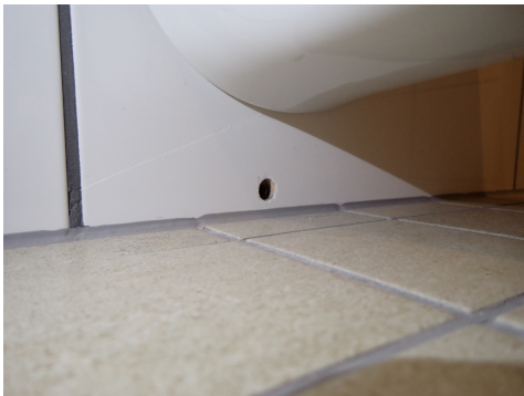
Sprekk i flis bak toalett
