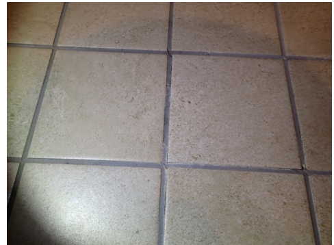
Eksempel på oppsprekking/småskader i fuger
