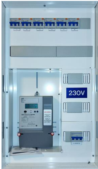
Forenklet vurdering av det elektriske anlegget - [Sikringsskap]
