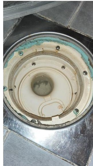
Avløpsrør (ink. sluk) - [Sluk bad]
