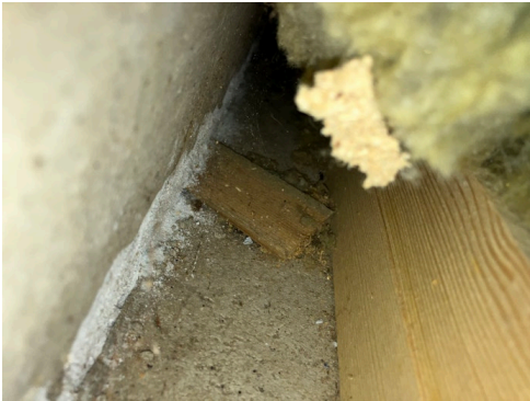
Bilde av konstruksjonen bak utforet vegg, her observeres det saltutslag på fritt eksponert murvegg i nedre del av vegg.
