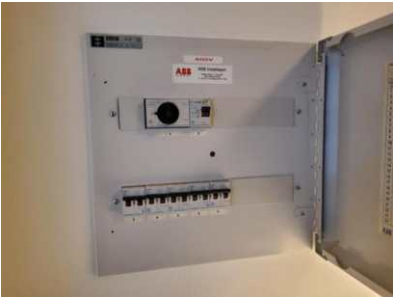
Elektrisk anlegg - [Sikringskap]
