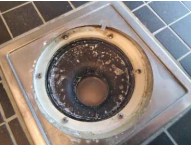
Ventilasjon - [Sluk i bad.]
