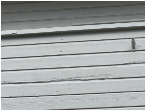
Råte i fort plank.
