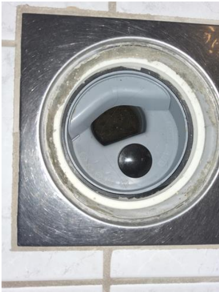
Avløpsrør (ink. sluk) - [Sluk utenfor dusjonen på bad i underetasje. ]
