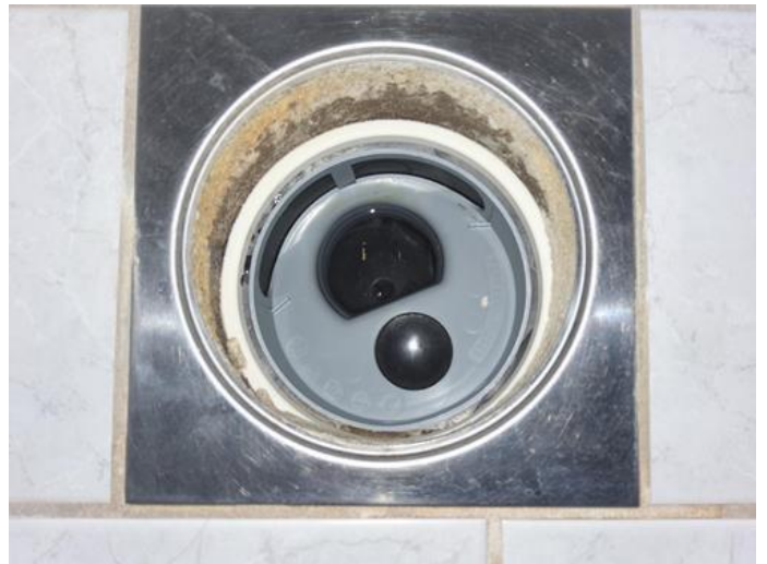
Avløpsrør (ink. sluk) - [Sluk i dusjonen på bad unnderetasje. ]
