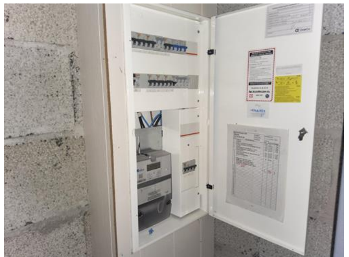
Elektrisk anlegg - [Sikringsskap. ]
