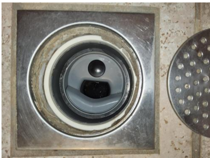
Avløpsrør (ink. sluk) - [Sluk i dusjonen på bad 1.etasje.]
