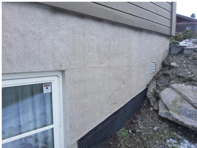
Grunnmur - [Riss/sprekker i grunnmur. ]
