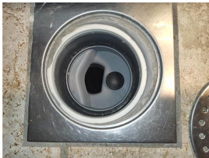
Avløpsrør (ink. sluk) - [Sluk utenfor dusjonen på bad 1.etasje.]
