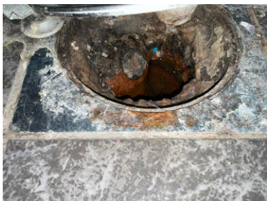
Sluk av soil under dusjkabinett.
