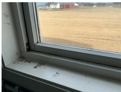
Vindu med punktert glass på bad.
