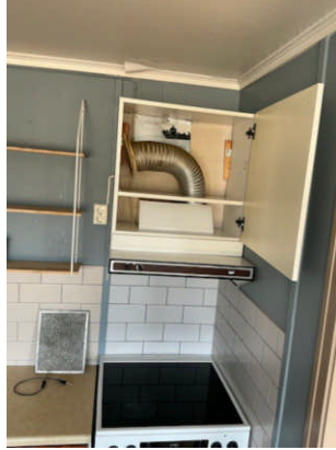
Avtrekk avsluttet inne i skap.
