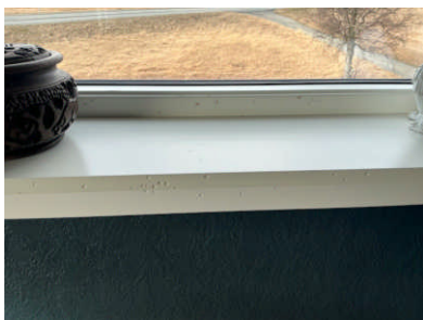
Hakk/ skader i vinduskarm og foringer.
