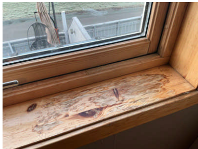
Slitasje i karmer og foringer på vinduer.
