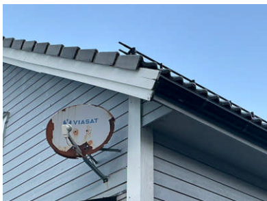
Skade/slitasje i vindski.
