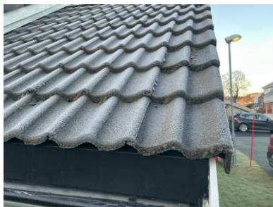
Mose ble registrert på takstein.
