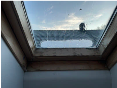
Sopp og slitasje i karm til takvindu på bad.
