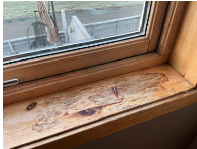
Slitasje i karm og foringer på vinduer.
