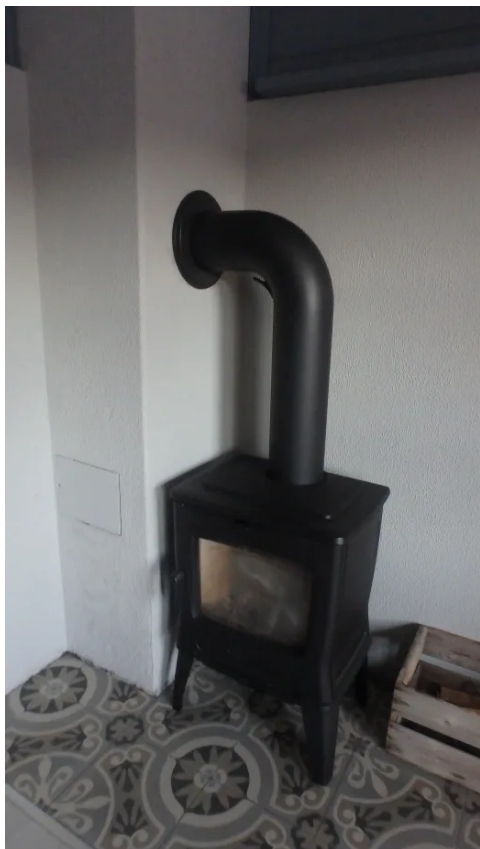
Vedovn på stue i sokkeletasje.
