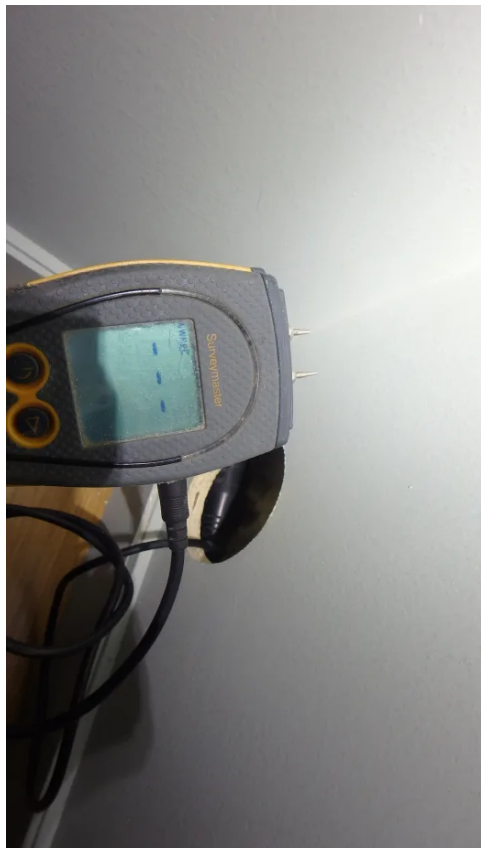
Fuktmåling i vegg fra teknisk rom.
