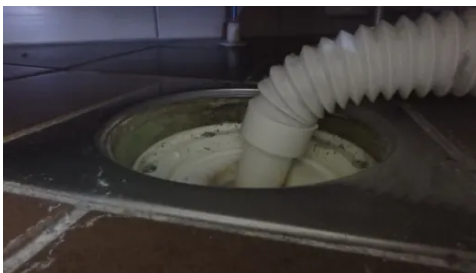
Sluk under dusjkabinett.
