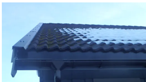
Taktekking med mose, overflater er delvis snødekt.
