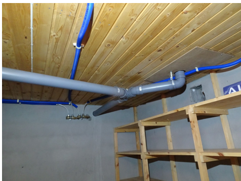
rør i rør med fordelerstokk i bodrom
