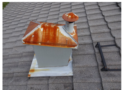
Gamle luftehatter med rust
