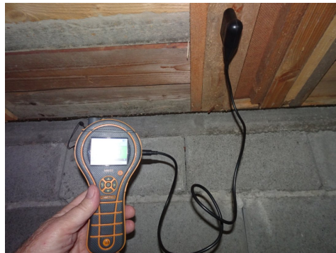
Fuktmåling, kun viser grønn sone.
