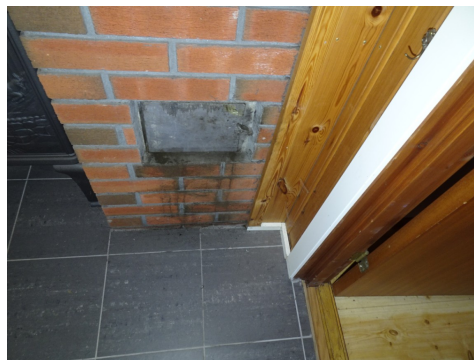
Sotluke i sokkeletg., brennbart materiale for nær sotluken.
