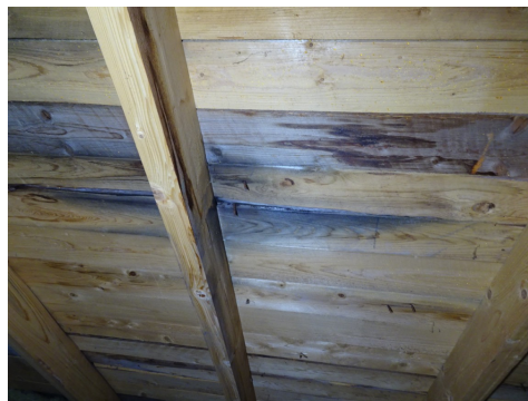
Svertesopp grunnet fuktpåvirkning
