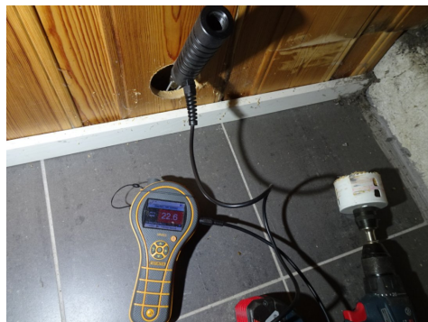
Fukt i konstruksjon 22,6% trefukt
