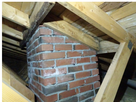
Fuktskjolder ved pipe nordvestre takflate
