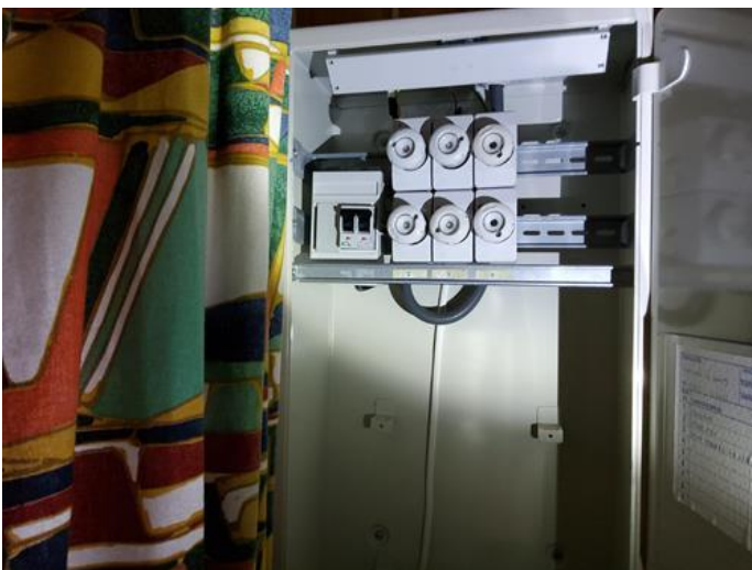
Elektrisk anlegg - [Sikringskaps anneks]
