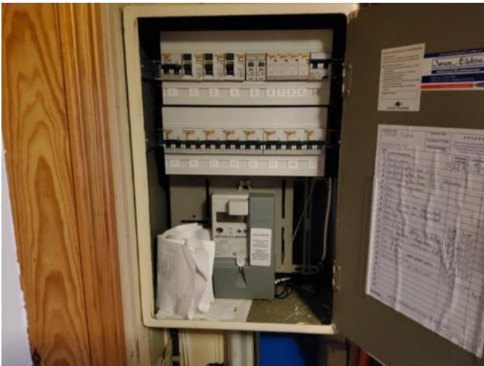
Elektrisk anlegg - [Sikringskaps hovedhus]
