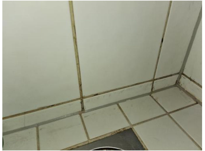
Helhetsvurdering - [Sprekker flis og flisfuger i dusjonen ]
