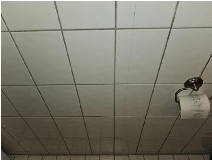
Helhetsvurdering - [Sprekk i veggfliser]
