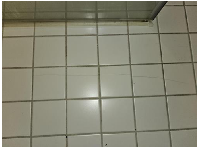
Helhetsvurdering - [Sprekk i gulvfliser]
