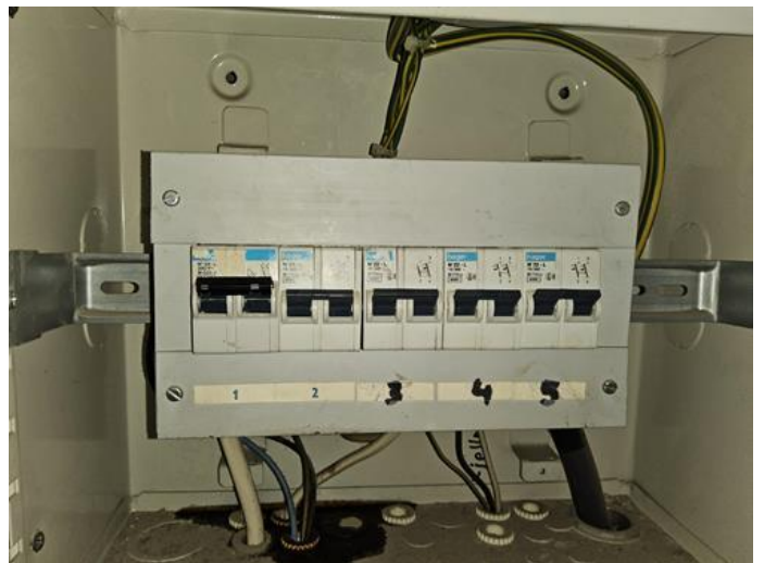
Elektrisk anlegg - [Sikringskap ]
