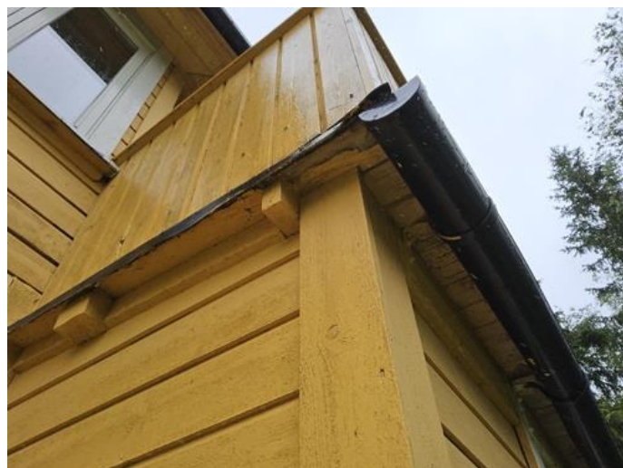
Balkonger, terrasser, veranda etc - [Fuktmerker på underkledning balkong. ]
