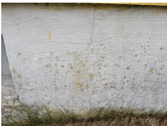
Grunnmur, fundamenter - [Sprekker grunnmur. ]
