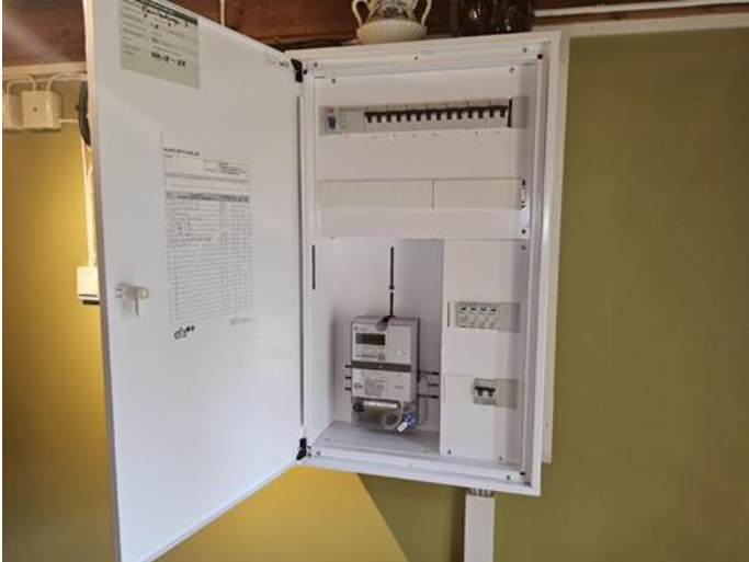
Elektrisk anlegg - [Sikringsskap 2.etg. ]
