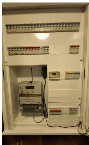
Elektrisk anlegg - [Sikringskap ]
