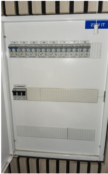
Elektrisk anlegg - [Sikringskap utleiedel ]
