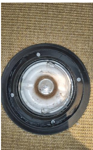
Avløpsrør (ink. sluk) - [Sluk på vaskerom ]
