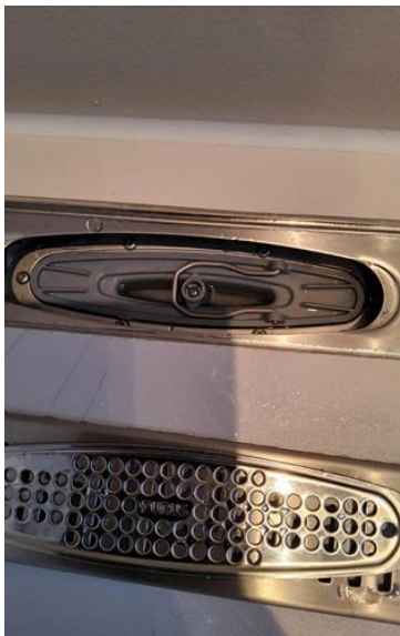
Avløpsrør (ink. sluk) - [Sluk på bad 1.etasje ]
