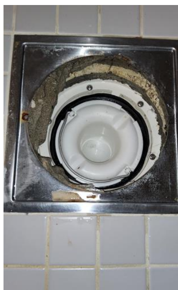
Avløpsrør (ink. sluk) - [Sluk på bad utleiedel ]
