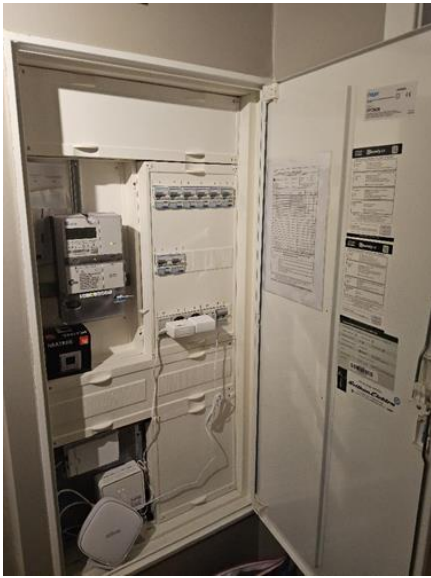
Elektrisk anlegg - [Sikringskap.]
