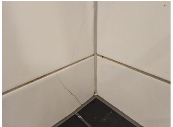
Våtrom - [Riss/sprekker på veggfliser i dusjsonen.]
