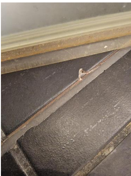
Våtrom - [Hakk i gulvflis.]
