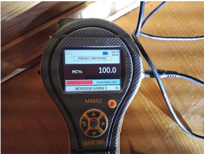
Rom under terreng (kjeller, underetasje, sokkeetasje) - [Fuktmåling utlektet kjellevegg (stue).]
