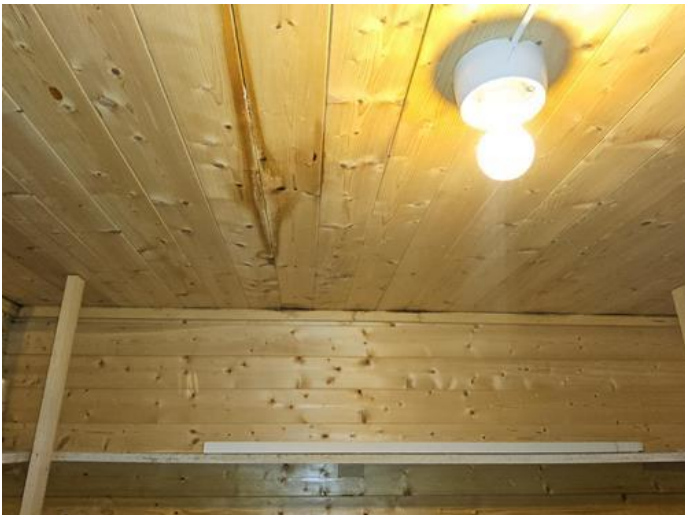
[Spesialrom (badstue, kjølerom, svømmebasseng etc). OBS! Bygningsfysikk.] - [Fuktmerker vegg/himling kjølerom.] ]
