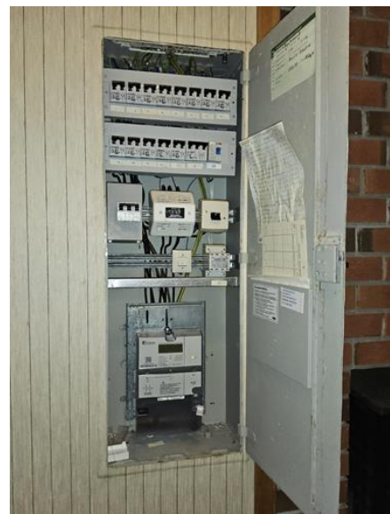
Elektrisk anlegg - [Sikringskap ]
