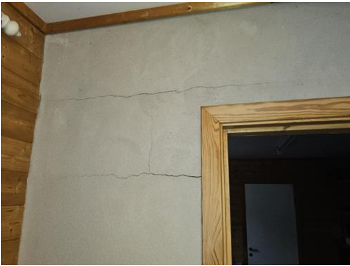
Grunnmur, fundamenter - [Sprekker på vegg/grunnmur i underetasjen.]
