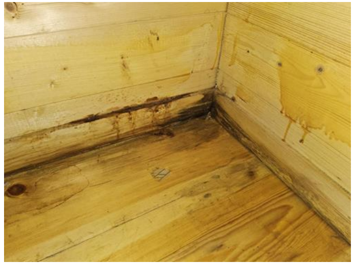
[Spesialrom (badstue, kjølerom, svømmebasseng etc). OBS! Bygningsfysikk.] - [Fuktmerker på gulv/vegger kjølerom.]
