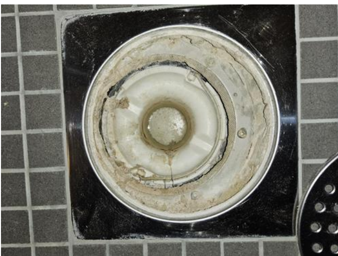
Våtrom - [Sluk bad 2.etg. ]
