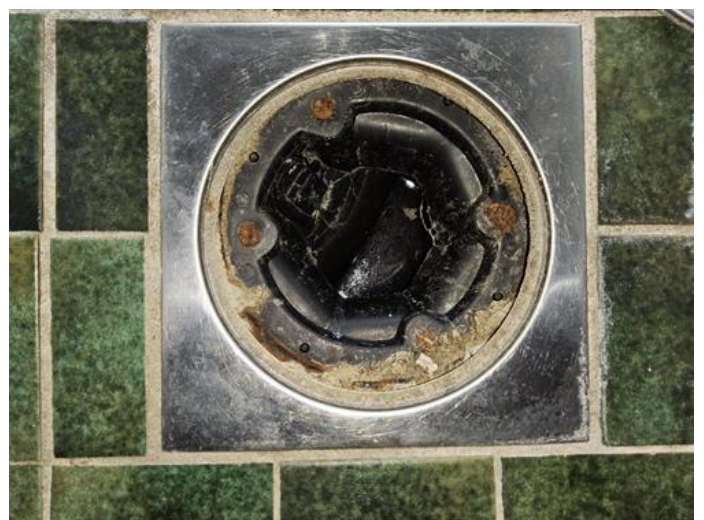
Våtrom - [Sluk bad 1.etg. ]
