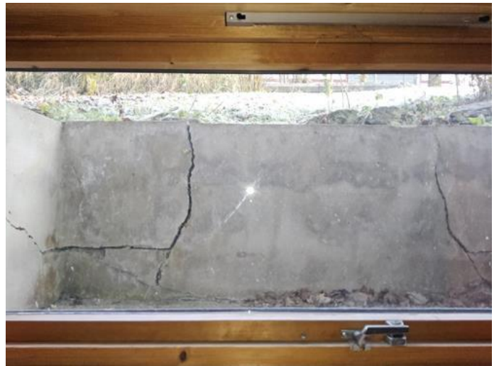
Dører og vinduer - [Sprekker på lysgrav.]
