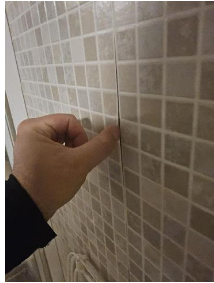
Våtrom - [Våtromstapet er stedvis slitt/løst.]
