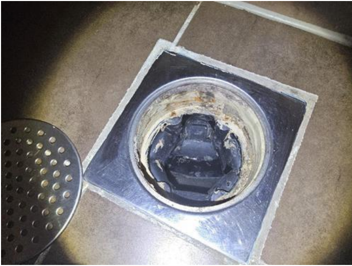
Våtrom - [Sluk på bad.]
