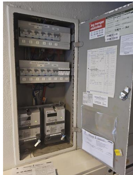
Elektrisk anlegg - [Sikringskap.]
