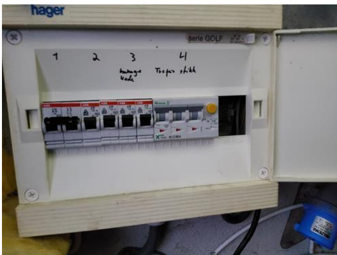
Elektrisk anlegg - [Sikringsskap garasje]
