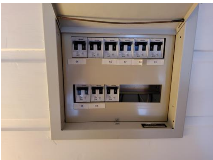
Elektrisk anlegg - [Sikringsskap 2. etg. enebolig.]
