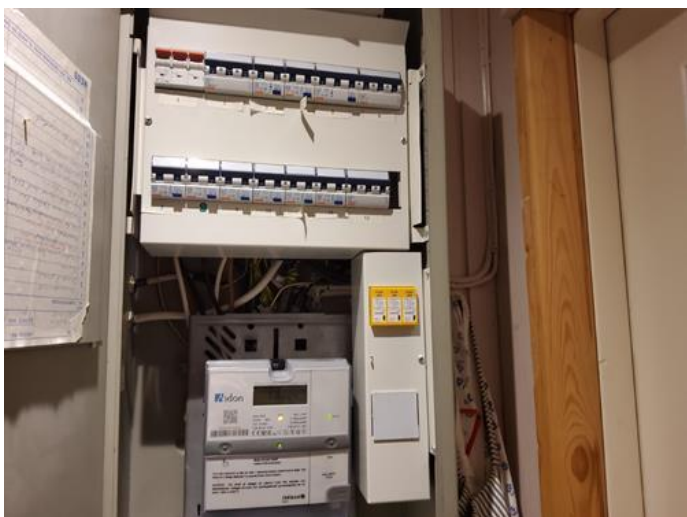
Elektrisk anlegg - [Sikringsskap trapperom enebolig]
