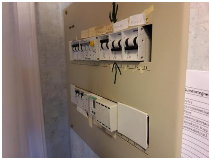
Elektrisk anlegg - [Sikringsskap vaskerom 1. etg. enebolig. ]
