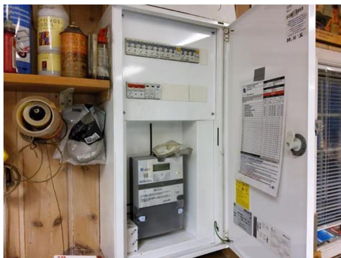
Elektrisk anlegg - [Sikringsskap garasje.]
