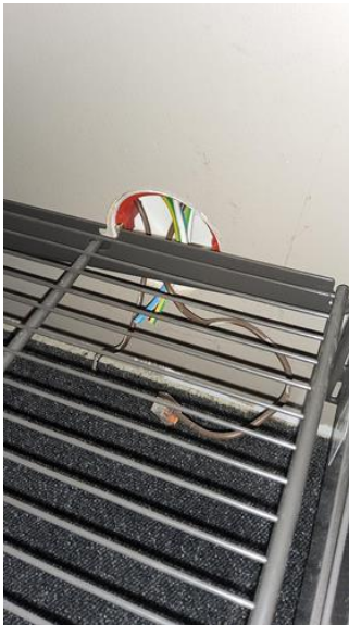
Forenklet vurdering av det elektriske anlegget - [Berøringsfare]
