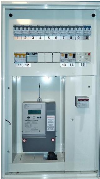
Forenklet vurdering av det elektriske anlegget - [Sikringsskap]
