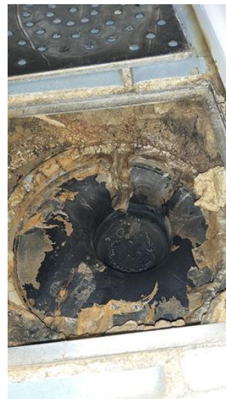
Helhetsvurdering - [Sluk bad underetasje]
