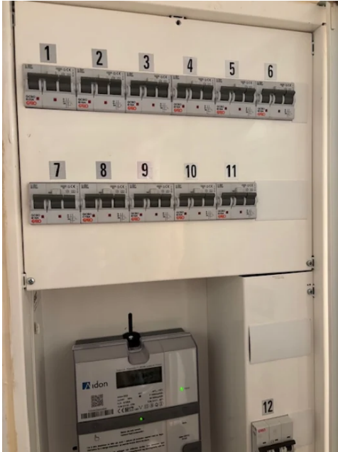
Sikringsskap med automatsikringer.
