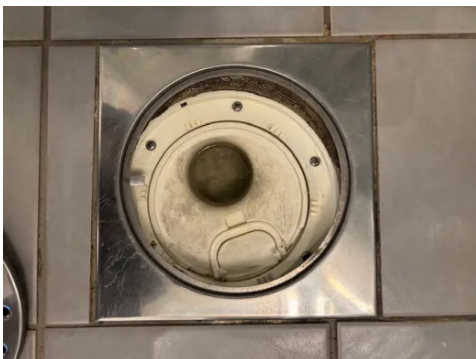
Baderomssluk plassert i dusjsone.
