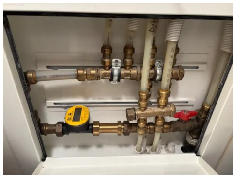
Rørfordelerskap med vannmåler og stoppekran synlig plassert og lett tilgjengelig i bod.
