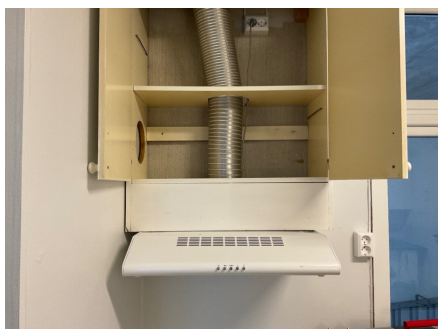
Mekanisk ventilator med avtrekk ut
