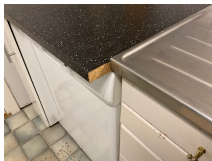
Ende på benkeplate mangler foliering
