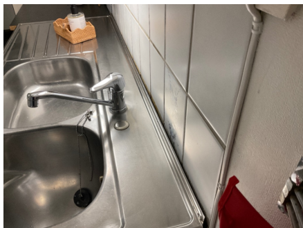
Glippe mellom vegg og oppvaskbenk.
