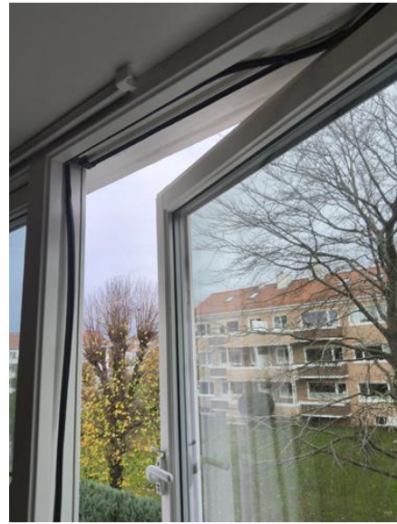
Vinduer - [Vinduer på soverom ]
