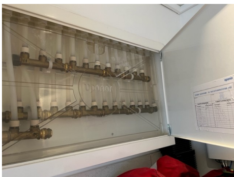
Fordelerskap for vannrør.
