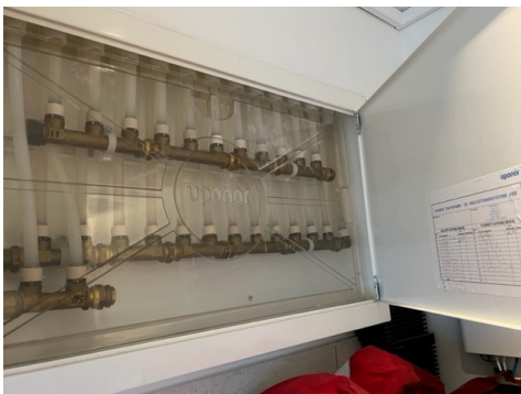
Fordelerskap for vannrør.
