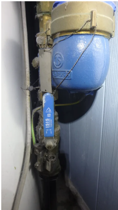
Stoppekrane os vannmåler på vaskerom.
