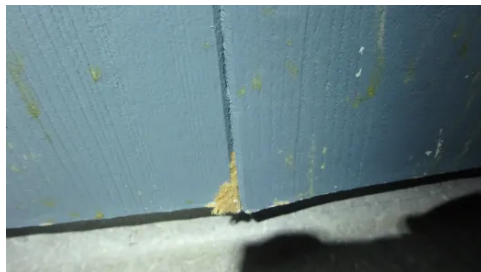
Eldre fuktskade i platevegg ved vaskemaskin.
