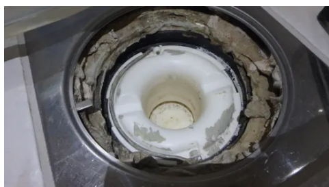
Sluk med synlig membran.
