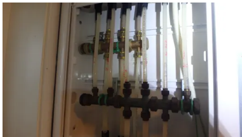
Rørskap på vaskerom.
