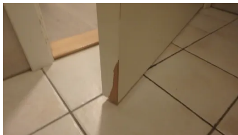
Fuktskade i dør til badet.
