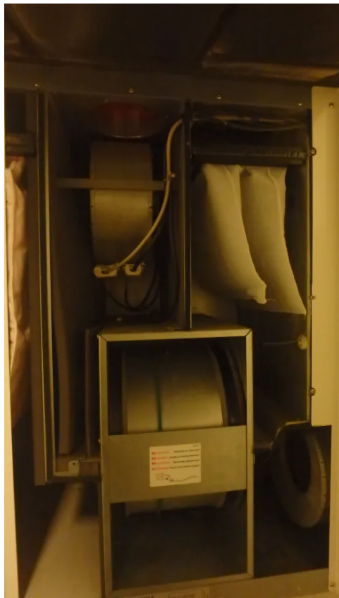
Ventilasjonsaggregat på teknisk rom.
