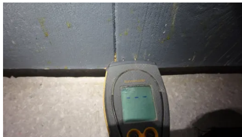
Fuktmåling i skade viser ingen tegn til fukt.
