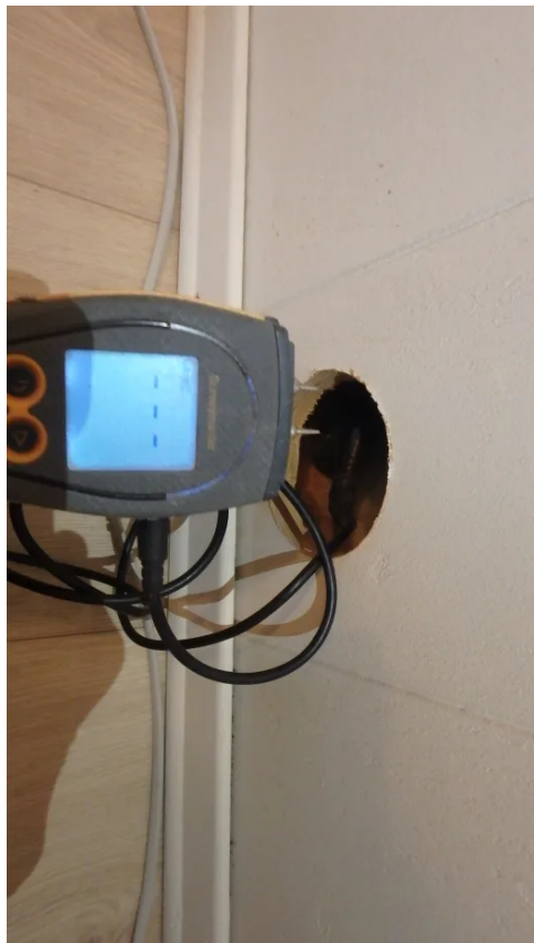
Fuktmåling i vegg fra tiliggende soverom.
