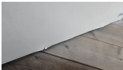
Fuktmerker/mindre skade i dørblad til bod.
