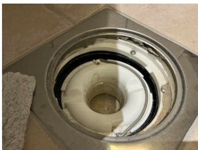
Sluk under innredning, ute på gulvet.
