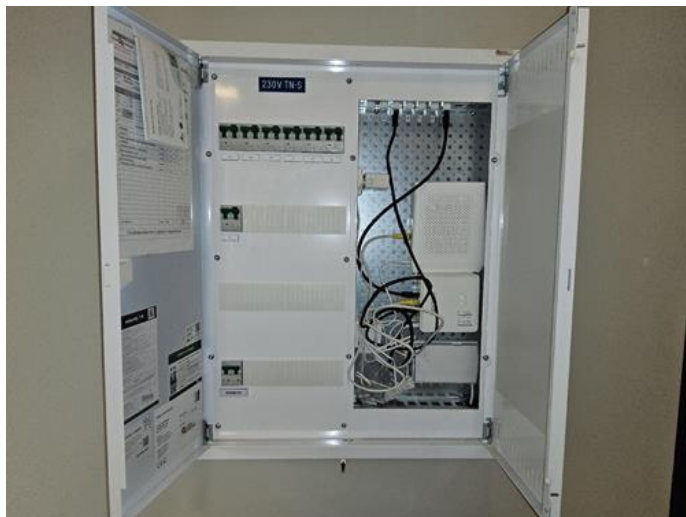
Elektrisk anlegg - [Sikringsskap ]
