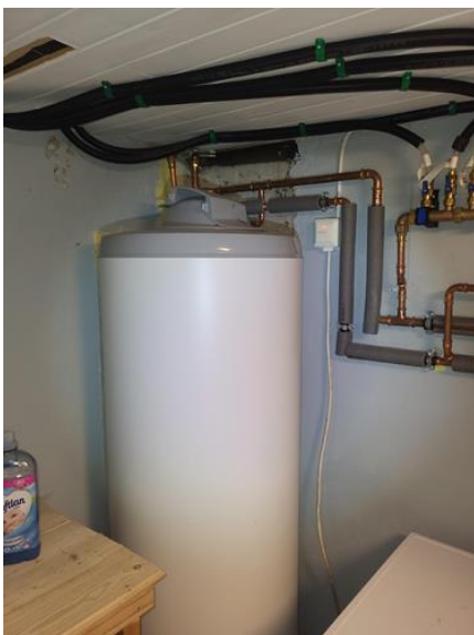
Tekniske anlegg, VVS anlegg (Sjekkpunkter utover det som
