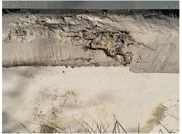
Utvendig - [Slitasje på gammel terrasse]
