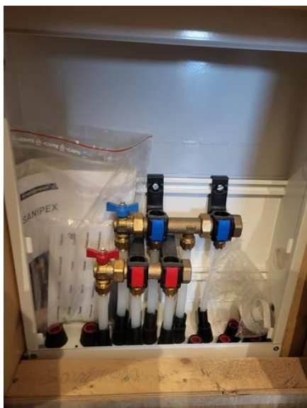
Tekniske anlegg, VVS anlegg (Sjekkpunkter utover det som er inkludert i andre rom) - [Koblingskap for vannrør på bad 2. etasje]
