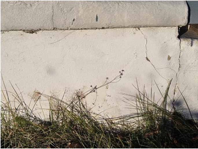
Utvendig - [Riss sprekker i mur gammel terrasse]
