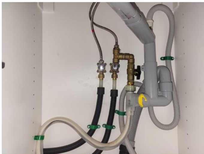
Kjøkken - [Røropplegg i kjøkkenbenk]
