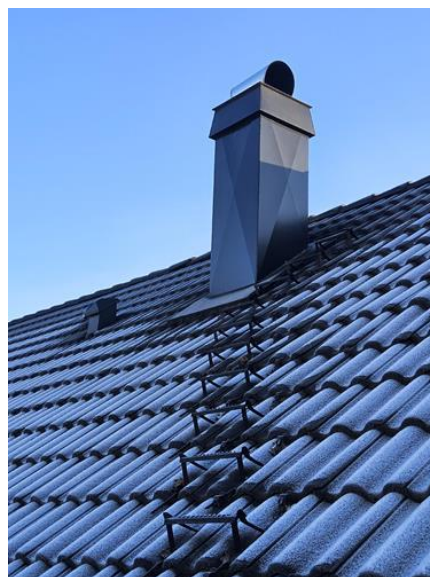
Utvendig - [Yttertak, stige-trinn til pipe]
