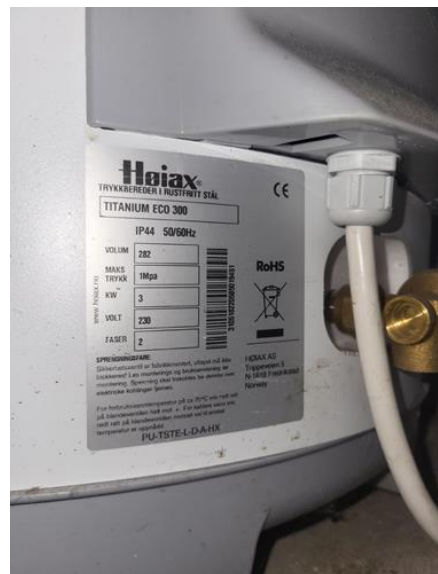
Tekniske anlegg, VVS anlegg (Sjekkpunkter utover det som
