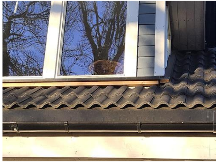
Utvendig - [Yttertak, overgang taktsein vegg, bør tettes bedre.]
