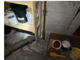
Stoppekran på inntak til boligen.
