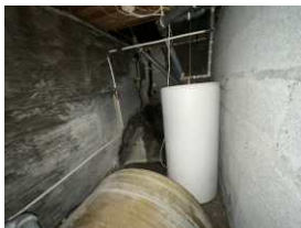
Vann/fukt på fjell i krypkjeller.
