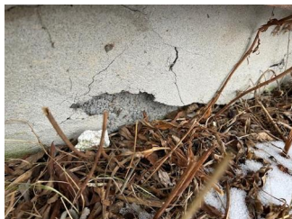
Grunnmur og fundament - Eksempel på avskalling grunnmur
