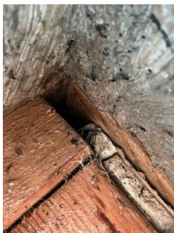
Gnagersikring - Eksempel på mangelfull gnagersikring
