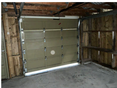
Eldre garasjeport fremstår som slitt, utett og med behov for renovering.
