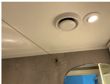
Avtrekk i himling.
