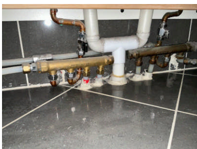
Ufagmessige gjennomføring i gulv, manglende membran/mansjetter for tetting. Rørfordeler under innredning.
