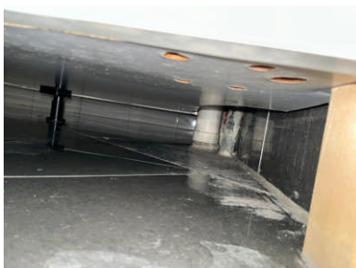
Gjennomføringer i gulv under innredning. Skader i bunnplate innredning. Bunnplate er også perforert med flere hull i platen.
