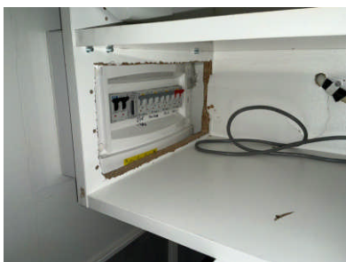
Sikringsskap til hybel er installert i overskap kjøkken.
