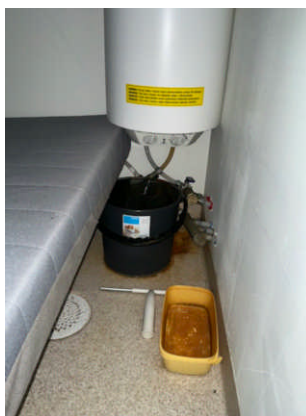
Varmtvannsbereder og røropplegg på hems, hybel.
