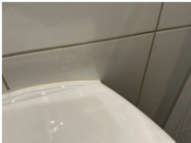
Sprekk i flis.
