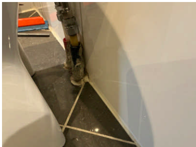
Ufagmessige gjennomføringer i gulv, manglende membran/mansjett for tetting.
