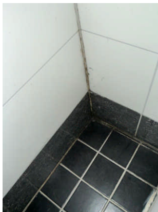
Slitte silikonfuger. Det er ikke benyttet hjørnelist på baderomsplater.
