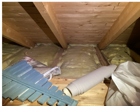
Ingen lufting ved takfoten og sort tereverk og isolejonen. Her må det etableres tiltrekkning lufting
