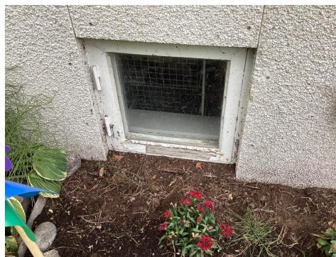
Koblet vind må byttes.
