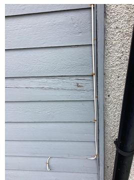
Mykt treverk/råteskadet på flere plasser rundt boligen. På under etasjen er det mye råte skadet bord. det nederste bordet er løst og mangler luftin, sikring mot skade dyr.
