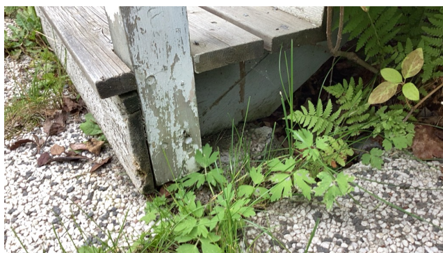
Fuktopptrekk og noe råteskadet.
