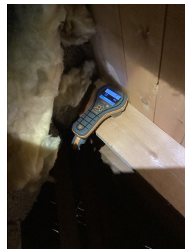
Gjennomføringen på pipe, gamle vannmerker men ingen forhøyet fuktverdier.
