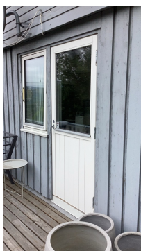
Terrassedør med maling avfalkking og fukt optrekk
