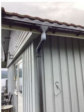
Falmete nedløp og renner, spillblekket har slått seg og er store kuler i takrenner.
