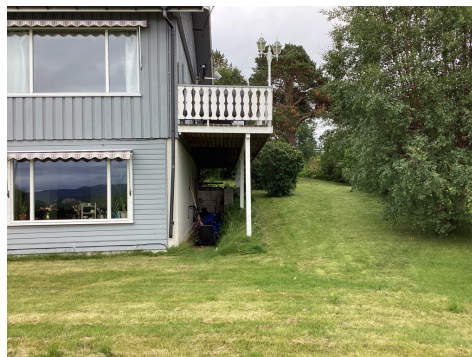
terrassen henger, kan se ut som søylene er seget ned og forskjøvet seg. anbefaler og montere nye søyle punkt/ søyler og dragere.
