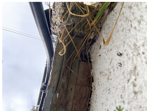
Manglede lufting og manglede sikring mot skadedyr.
