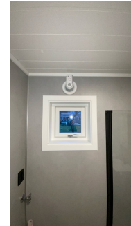
Fuktstyrt mekanisk avtrekksvifte og åpningsvindu
