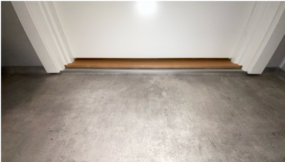
Tilluftsspalte under dør
