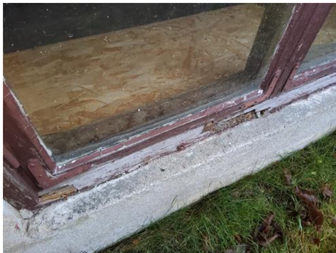
Annet - [Slitasje på kjellervindu]
