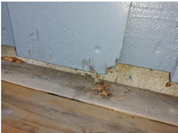
Beskrivelse - [Eksempel på råteskader på kledning]
