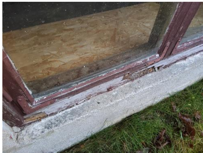
Annet - [Slitasje på kjellervindu]
