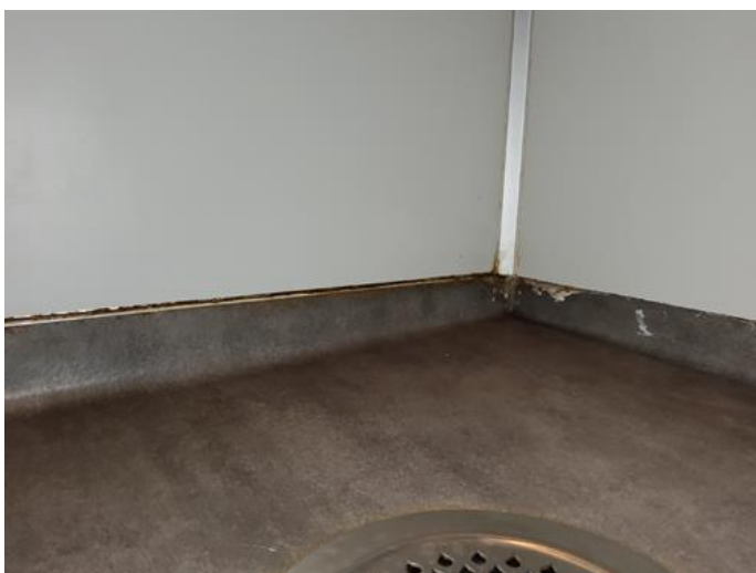
Overflater vegg - [Eksempel på mangelfull utførelse av baderomsplater.]
