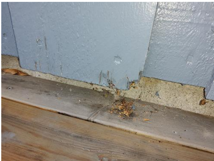
Beskrivelse - [Eksempel på råteskader på kledning]
