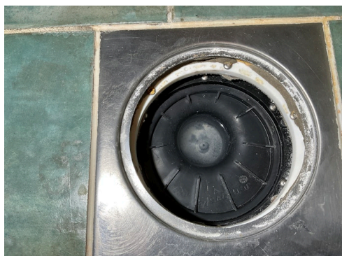
Sluk i dusjsone.
