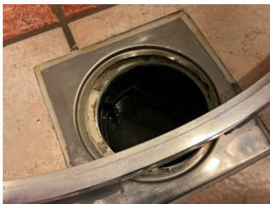
Sluk i dusjsone.
