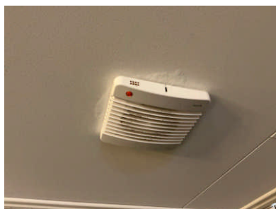
Fuktmerker rundt ventil i himling.
