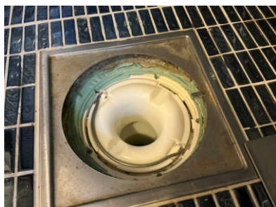
Sluk i dusjsone.
