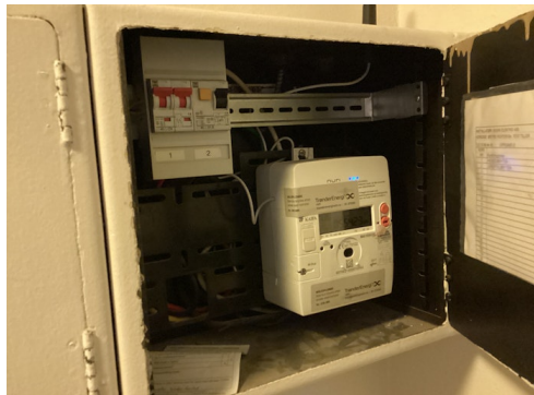
Bilde av sikringskap
